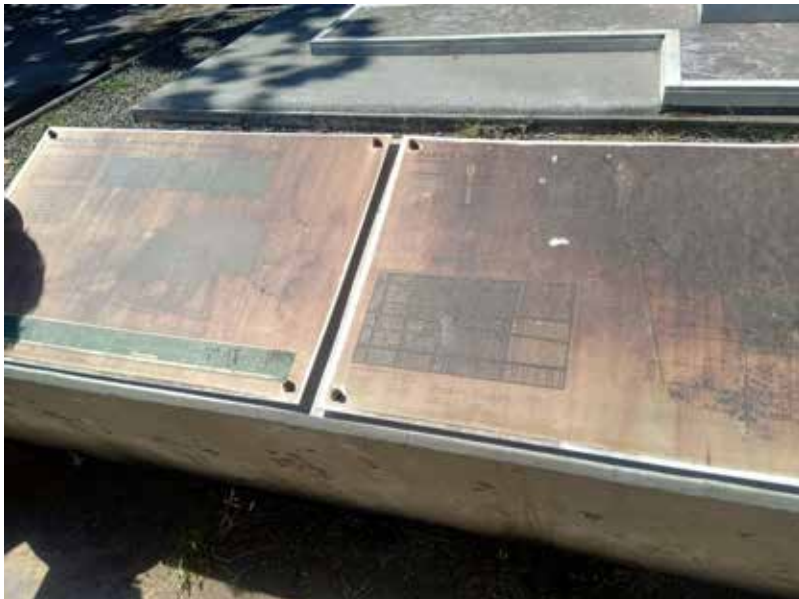
Figura 12. Deterioro de señalética informativa generado durante la implementación del Plan de Interpretación del Cementerio General de Santiago de Chile. (Fotografía del autor, 2021)
