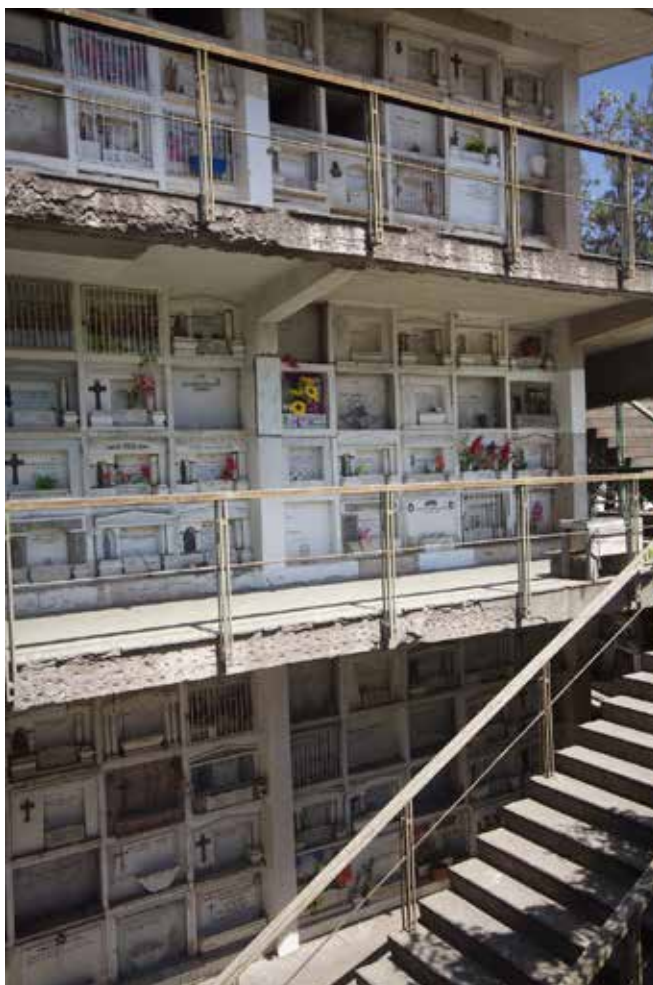
Figura 9. Deterioro de las losas de hormigón de los nichos del sector norte del Cementerio General de Santiago de Chile. (Fotografía de Rafael Grau, 2021)
